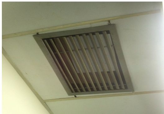
Figura 1 – Duto de ar condicionado central
