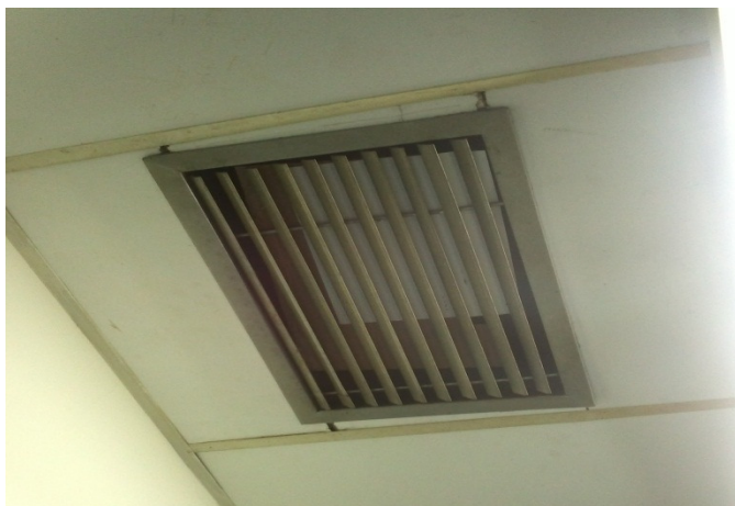
Figura 3 - Duto do ar condicionado central.
